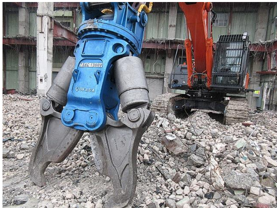
解体環境アタッチメント (サイレント TSRC クラッシャー) SRC 構造など多様な建物構造に対応した 進化型アタッチメント。1台でコンクリー トの破碎と鉄筋・鉄骨の切断を行えます。
