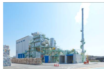
利根川事業所のバイオマス焼却設備
