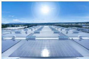
昼間の電力は太陽光発電で賄う福島矢吹工場
