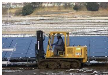
メガソーラー設置用 フォークリフト
