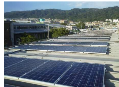
太陽光発電設備
