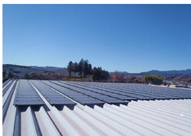
太陽光パネル
