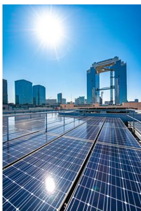
① 本社ビル屋上ソーラー
