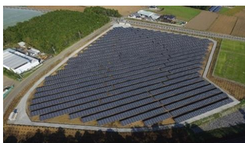
太陽光発電所
